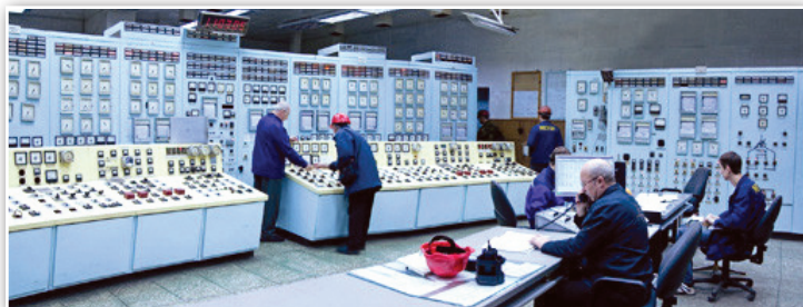
6. У пульта управления агрегатами станции
